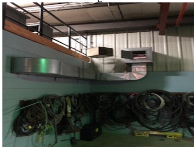
Warehouse/Maintenance Fan Unit
